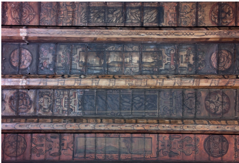
Fot. 2. Fragment stropu pomiędzy 16 a 20 belką, fot. Paweł Suchanek
