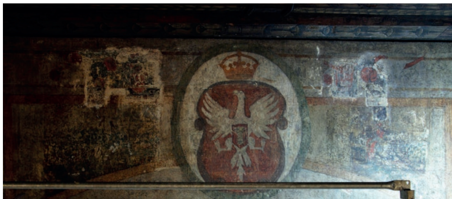
Fot. 4. Odkrytki na ścianie zachodniej, fot. Agata Malik-Ptaszyńska
